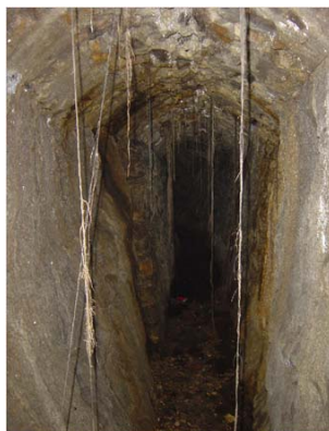
Les racines d'arbres traversent cette galerie située à deux pas du tunnel de la Croix-Rousse, © esion
